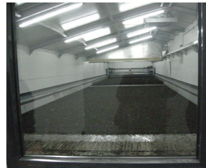
Bild EBA, Innenansicht Klärschlamm-Trocknungsanlage Klettgau-West
