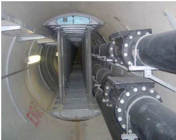
Stollensystem zur Sickerwasserableitung
