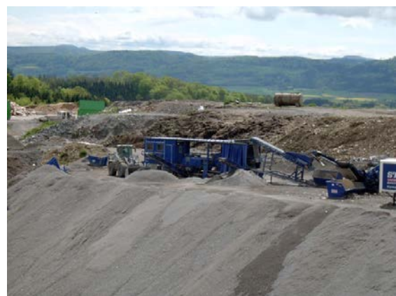
Betriebsfläche für die Schlackenaufbereitung
